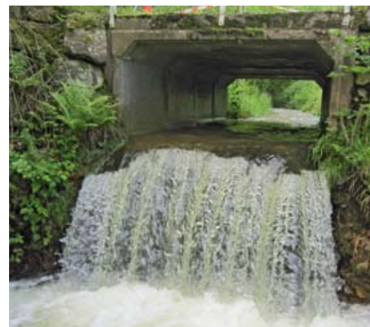
Le seuil et le radier en béton de l'ancien pont empêchaient les truites de remonter le cours d'eau.
